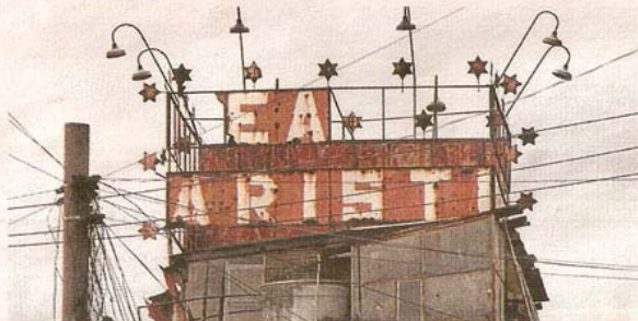
El letrero del Teatro Aristi fue acabado tanto por óxido como por el olvido, así quedó. COLECTIVO MASKI
